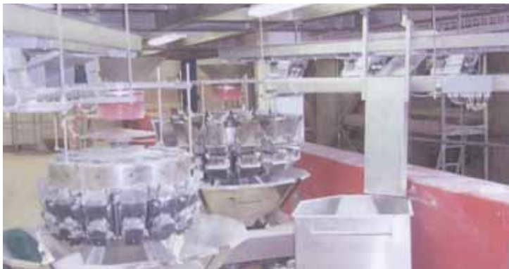
Alimentadores dosificadores para las escalas de alimentación
